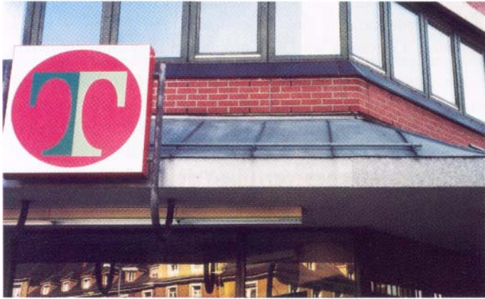
Bild 4: Belüftungsöffnungen auch im Bereich einer schmalen Brüstung zur Erfüllung der Norm.
